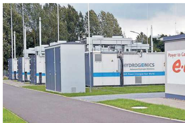
Die Power-to-Gas-Anlage im Gewerbegebiet Falkenhagen
